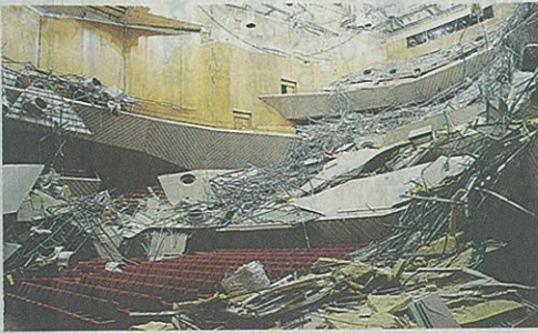
天井建材などが崩落したミュージザ川崎シンフォニーホール
